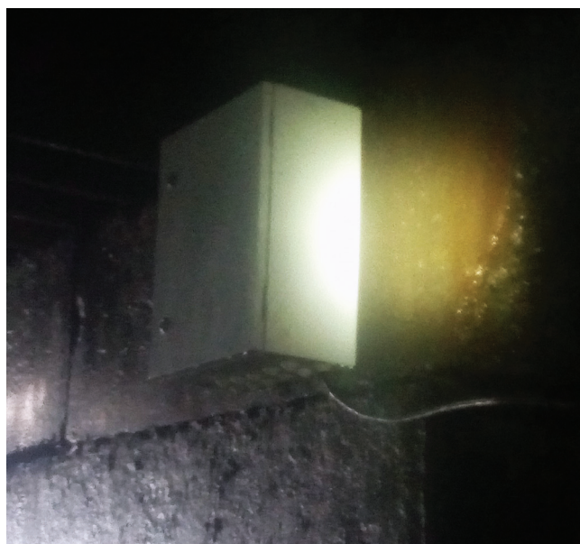
Рис. 5. Шкаф с сотовым модемом. Расположен вблизи выхода из шахты. Используется для передачи данных от шлюза на сервер
